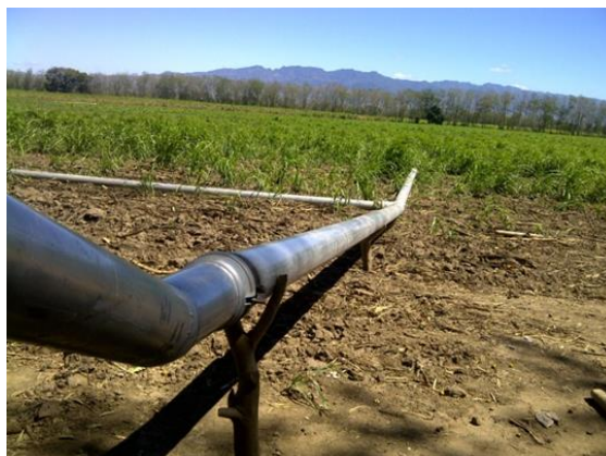
Fotografía 2. Tubería de impelencia que se dirige hacia el ramal de distribución
